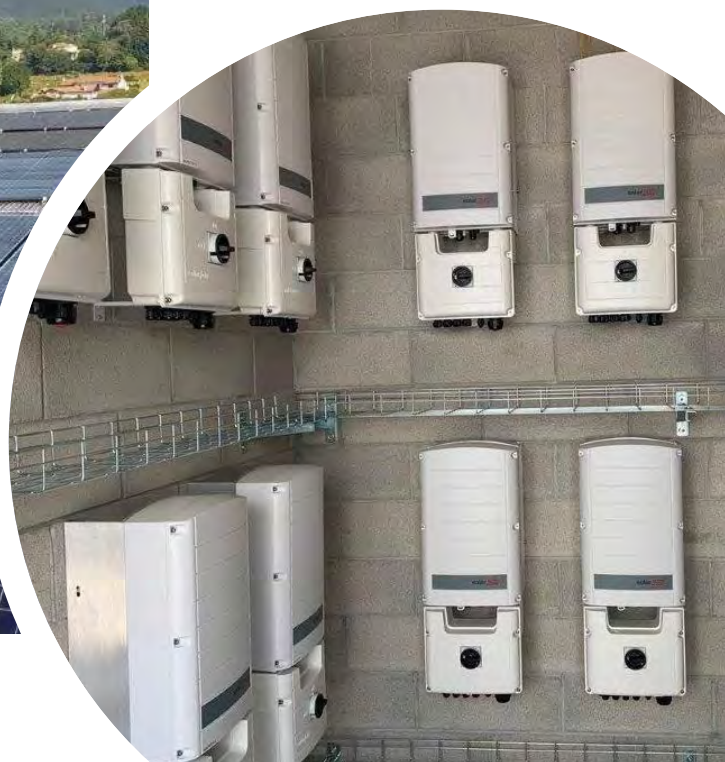
L'impianto fotovoltaico sopra lo stabilimento produttivo di Bizzotto ad Arquà Polesine, in provincia di Rovigo
